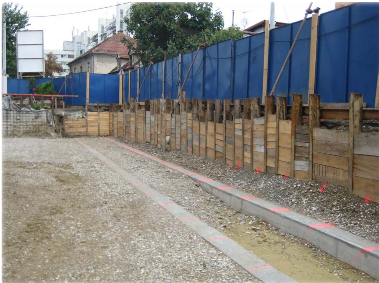
Primjena Europskih normi – bušeni piloti kroz primjer izvedbe sekantne stijene u Kupskoj ulici
